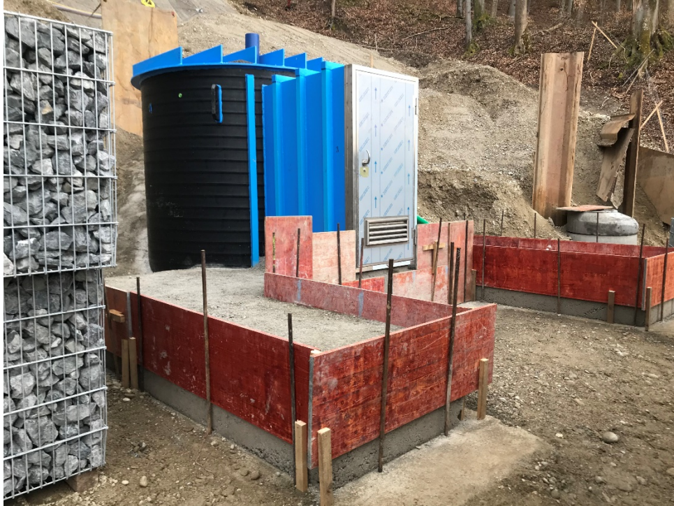
... PE-Quell-Sammelschacht mit Fundament
