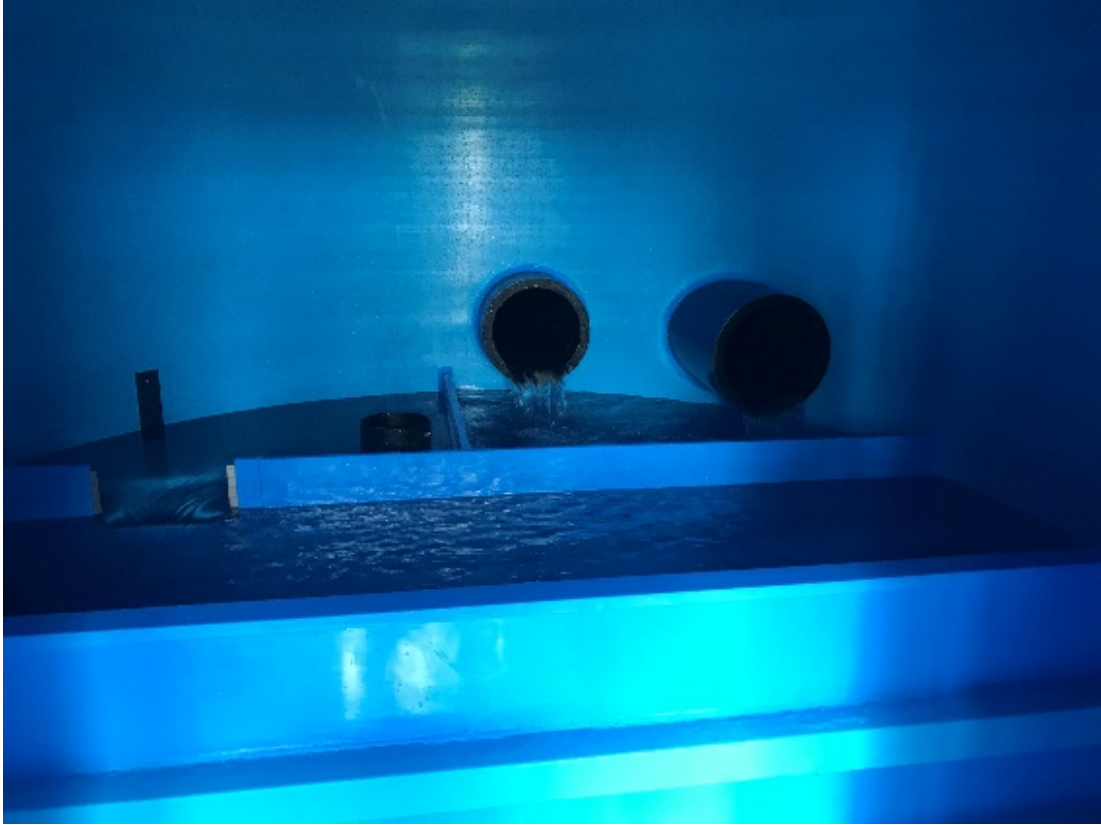
Blick in den neuen Quellsammelschacht mit einer Quellschüttung von aktuell ca. 13 l/sec.
