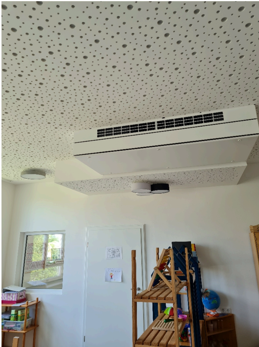
Lüftungsanlage mit Akustikdecke (Foto Maier M.)
